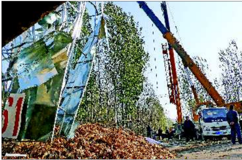
吊车侧翻后,长长的吊臂将巨型广告牌砸得变形。本报记者 陈文进 摄
