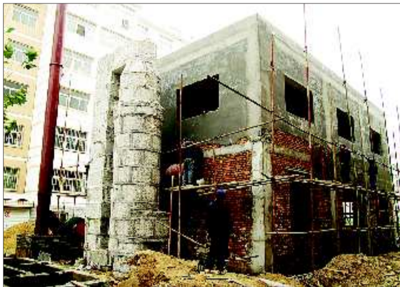
21日上午,欣王嘉苑小区内施工人员正在新建锅炉房。工作人员表示,小区锅炉还需要10来天才能正式供暖。本报记者 徐乐静 高倩倩 摄
