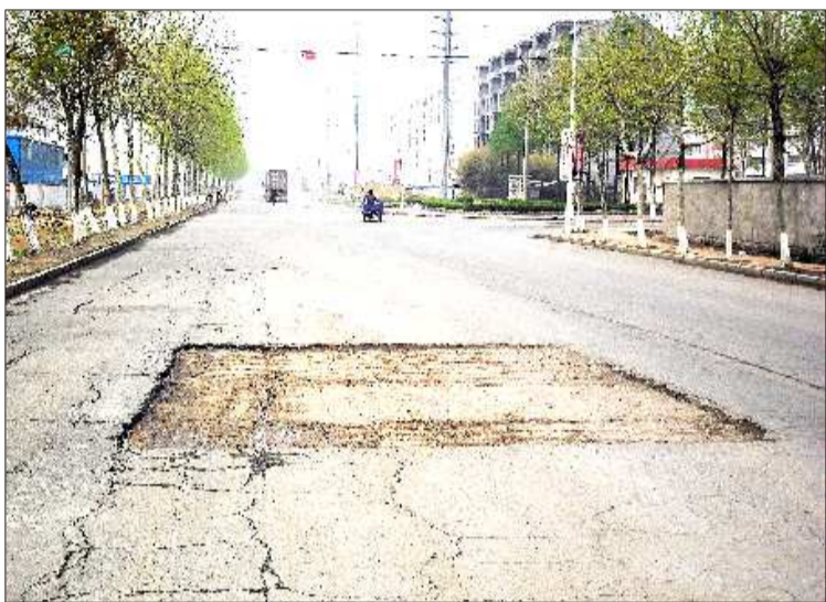
兴海路西段的一处方坑,长约6米,宽约5米,几乎占据了路面宽度的1/3。
