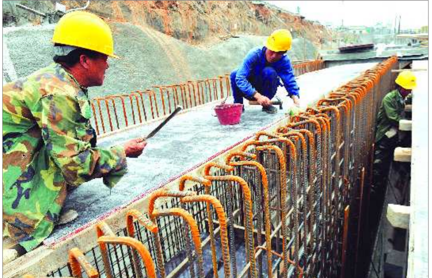
在匡山大街以南的施工现场,工人们在加紧建设管线共同沟。 本报记者 郭建政 摄
