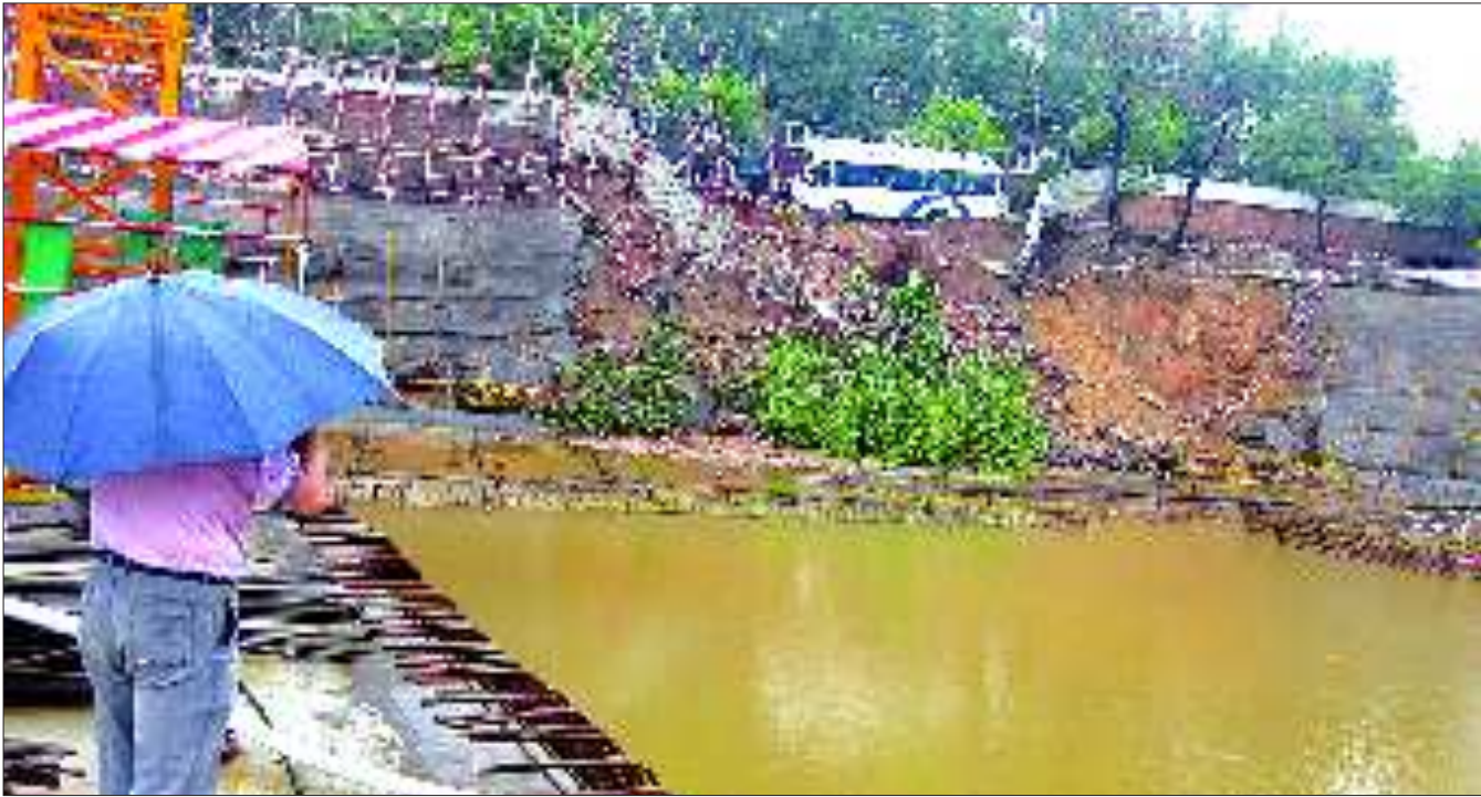
工地塌方,大客车差点掉进十几米深的基坑内。 本报记者 赵波 摄
