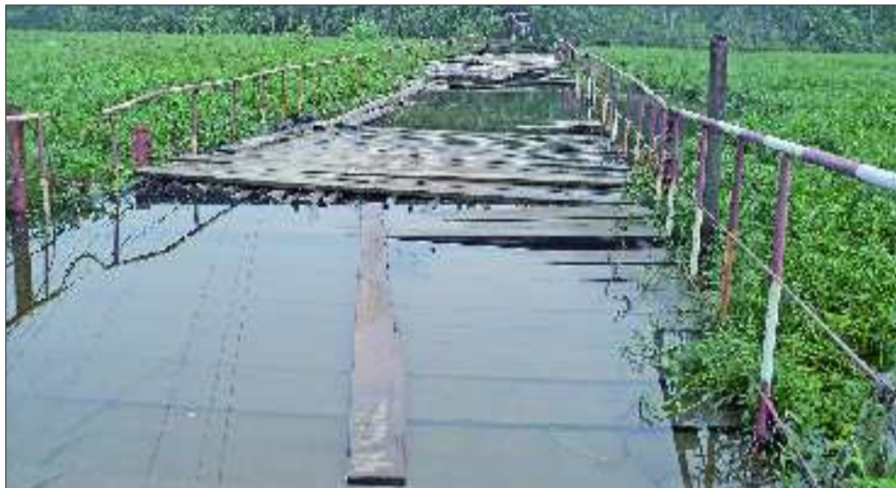
被淹的洸府河浮桥。本报记者 晋森 摄
