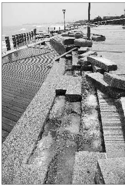
8日,灯塔广场遭台风破坏。 记者 张照朋 摄
