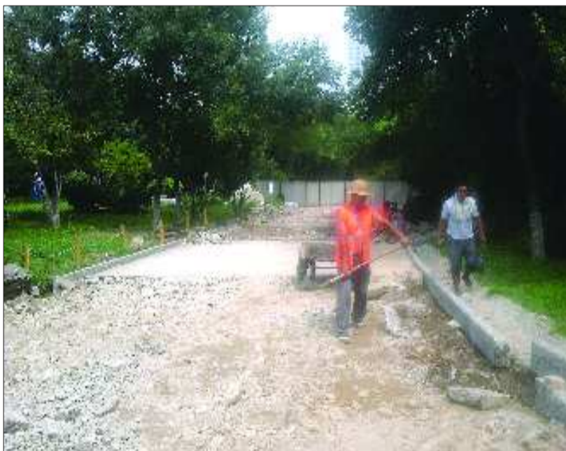
施工人员正在千佛山东门附近安装路沿石。 本报记者 王光照 摄
