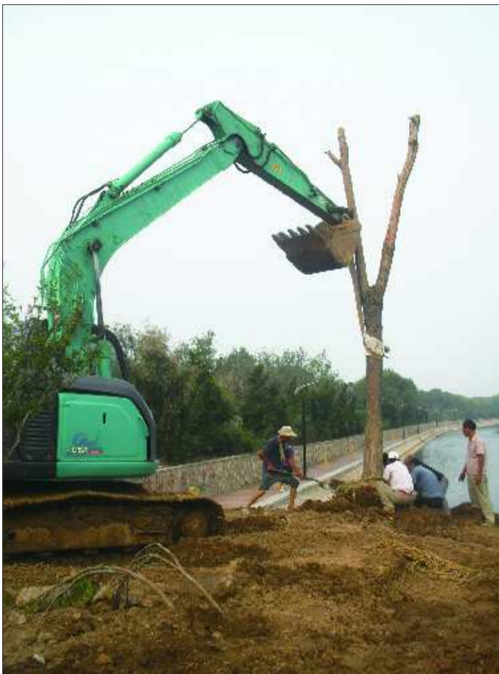
9日下午,施工人员在将柳树栽植在月季园内。 本报见习记者 李金金 摄
