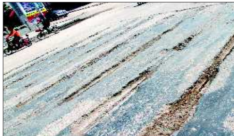
新水河振兴路桥面北侧桥面出现了七八条裂缝。
