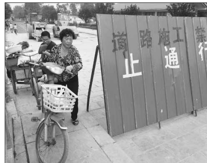
西关街道路损毁严重,坑坑洼洼。目前,该路段正封闭施工,禁止机动车通行。本报记者 李军 摄影报道
