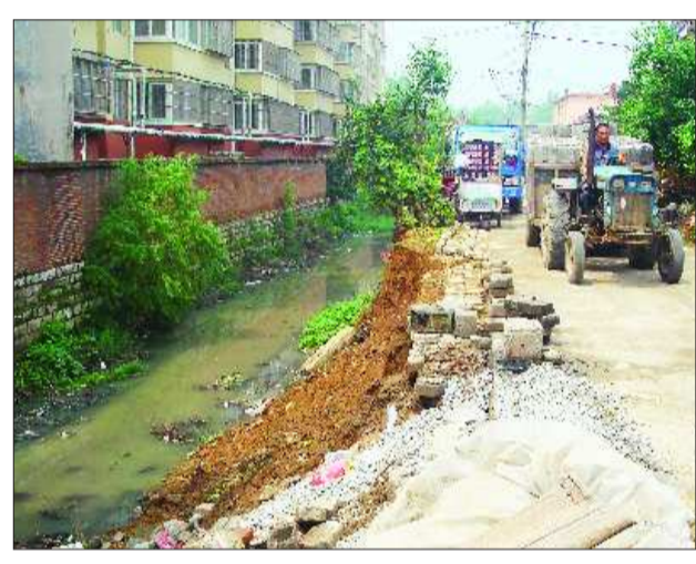
坍塌的墙体有近20米长。
