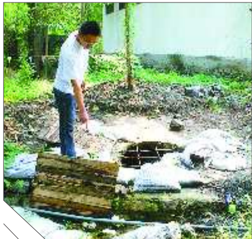
臭水沟里的水流进这个“天坑”。
