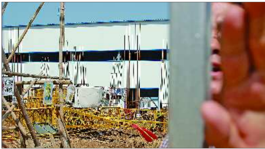
事发现场,一座塔吊斜横在地面上,工作人员拒绝采访。 梁敏 摄
