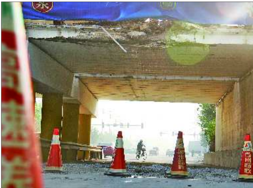
被撞损的高速公路涵洞。 本报记者 马志勇 摄
