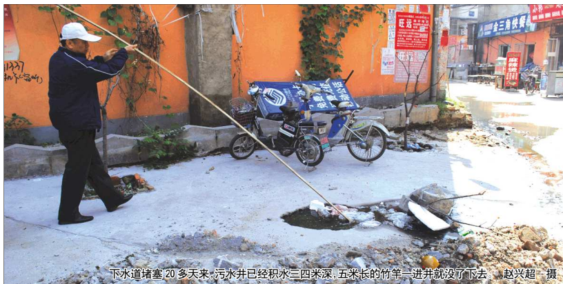
下水道堵塞 20 多天来,污水井已积水三四米深,五米长的竹竿一迸就没了下去。赵兴超 摄
