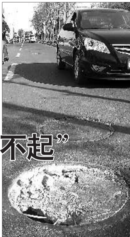
▶17日下午记者在青年路看到,一个井盖出现了严重的损坏,钢筋已经裸露在外面。
