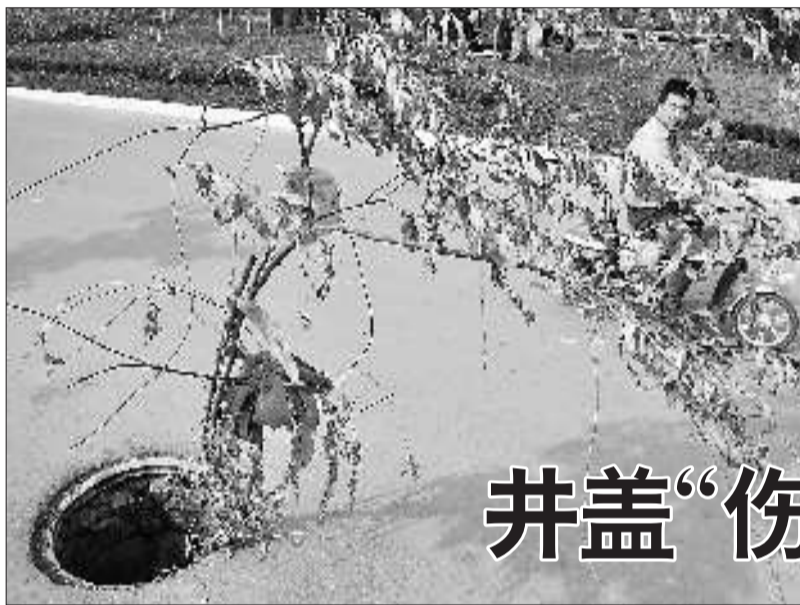
▲18日,德州新河东路上,一处暗井的井盖损坏,有人为了提醒过往行人,在井里插上了柳树枝,并挂上了醒目的红色塑料袋。
