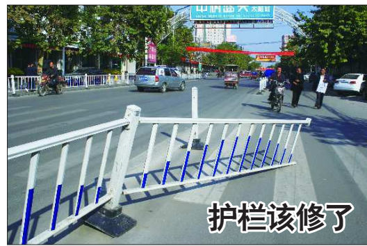
18日,滕州市荆河中路护栏歪倒在一边,给过往的车辆和行人带来很多不便。市民呼吁,相关部门应该及时修补破损护栏。本报记者 孔红星 摄
