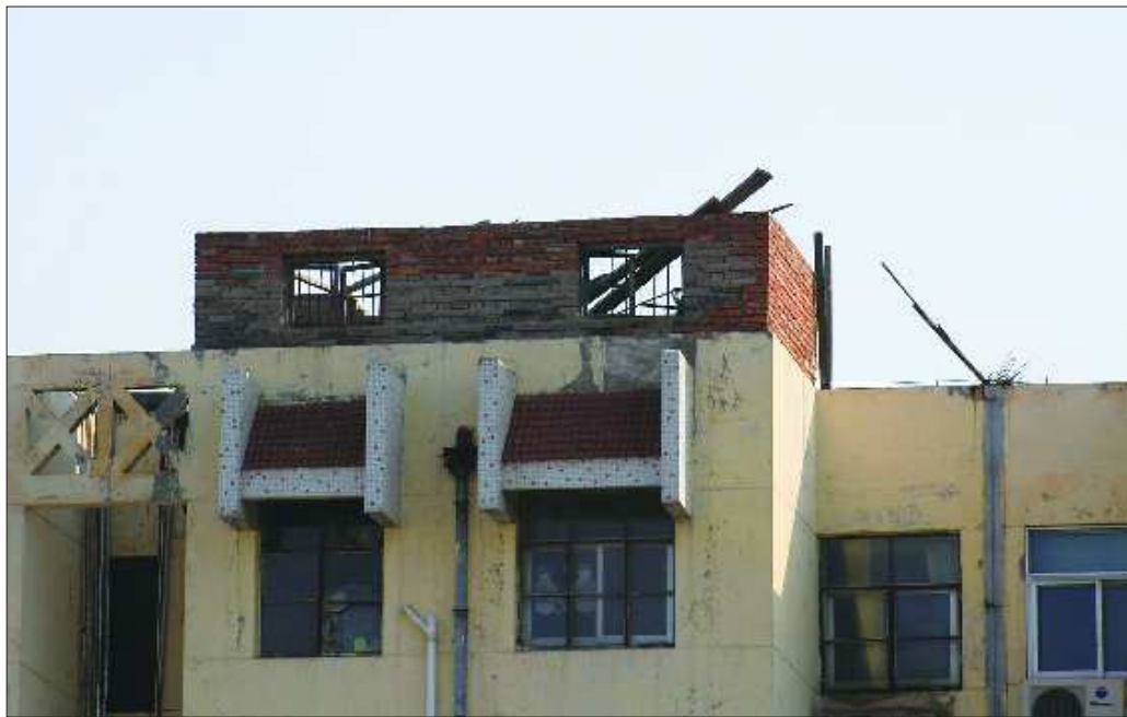
21号楼顶加盖的高层,停工后一直没有清理。本报记者 孔红星 摄
