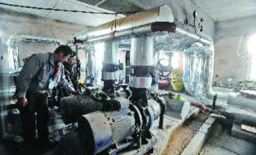
一小区供热站,工人们在供热前检查设备运行情况。 本报记者 周青先 摄
