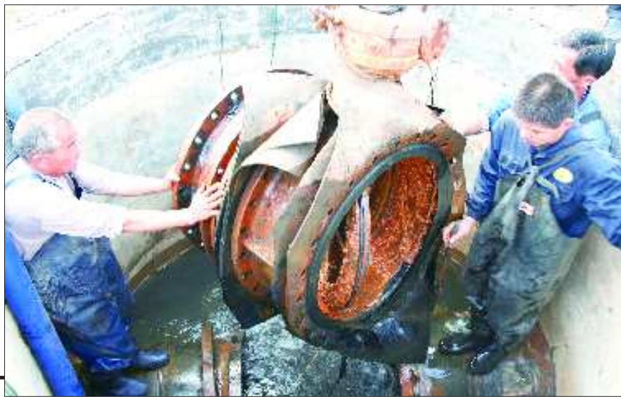
吊出的阀门内已经锈迹斑斑,两头的橡胶圈也已老化。本报记者 郝文杰 摄
