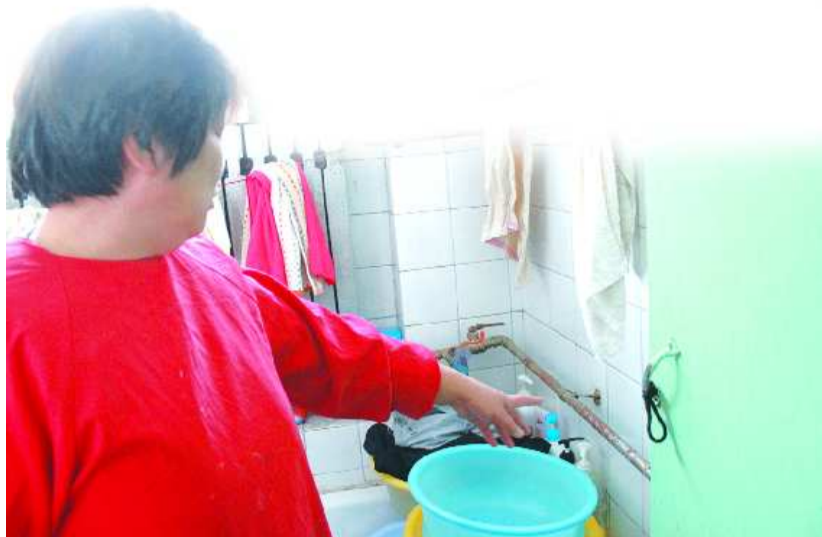
住在B楼一层的齐女士向记者展示自家被锈蚀的暖气管道。本报记者 王健 摄
