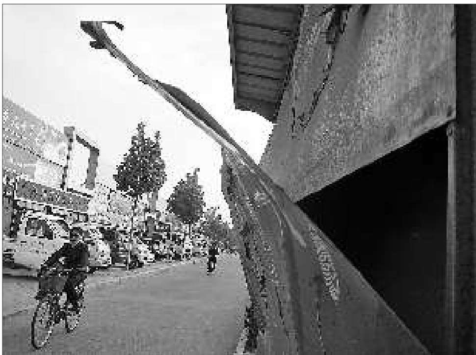
10月27日, 德州湖滨大道陶瓷大市场处的公交站广告牌破损, 开裂的铁皮伸向非机动车道, 路上的行人面对锋利的铁皮远远避让。
