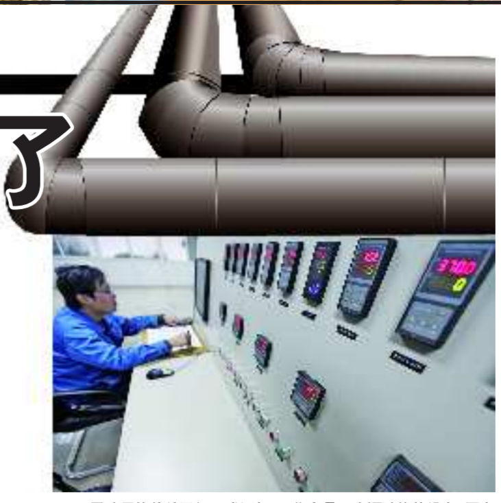
▲民政局换热站已经正式运行,工作人员正在调试换热设备,压力表显示压力正常。 通讯员 范文 摄
