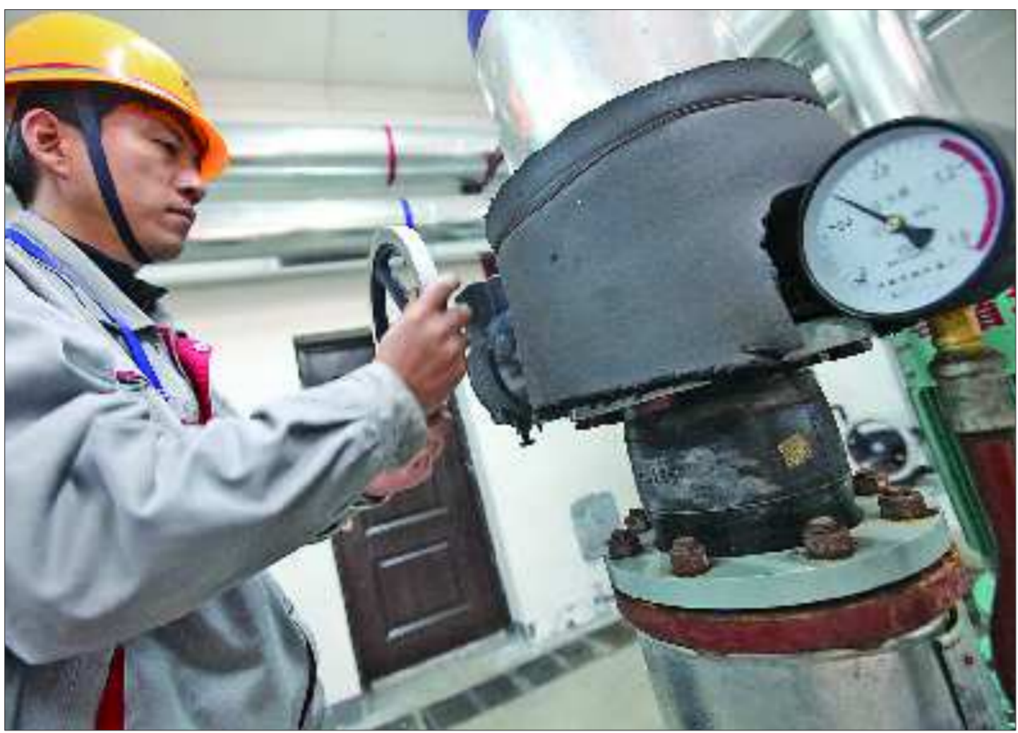
▲丁字山热源厂内,工作人员正在监控室内,观察锅炉运行是否正常。
