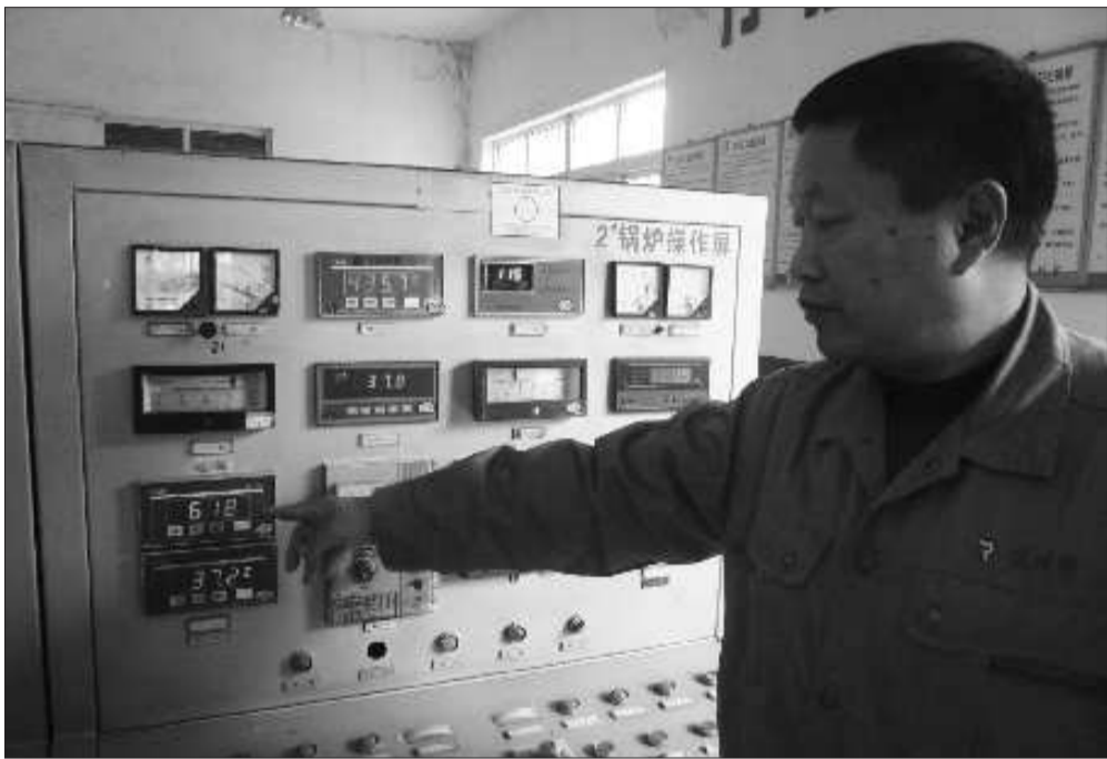
图为烧煤处的智能化监测设备。
