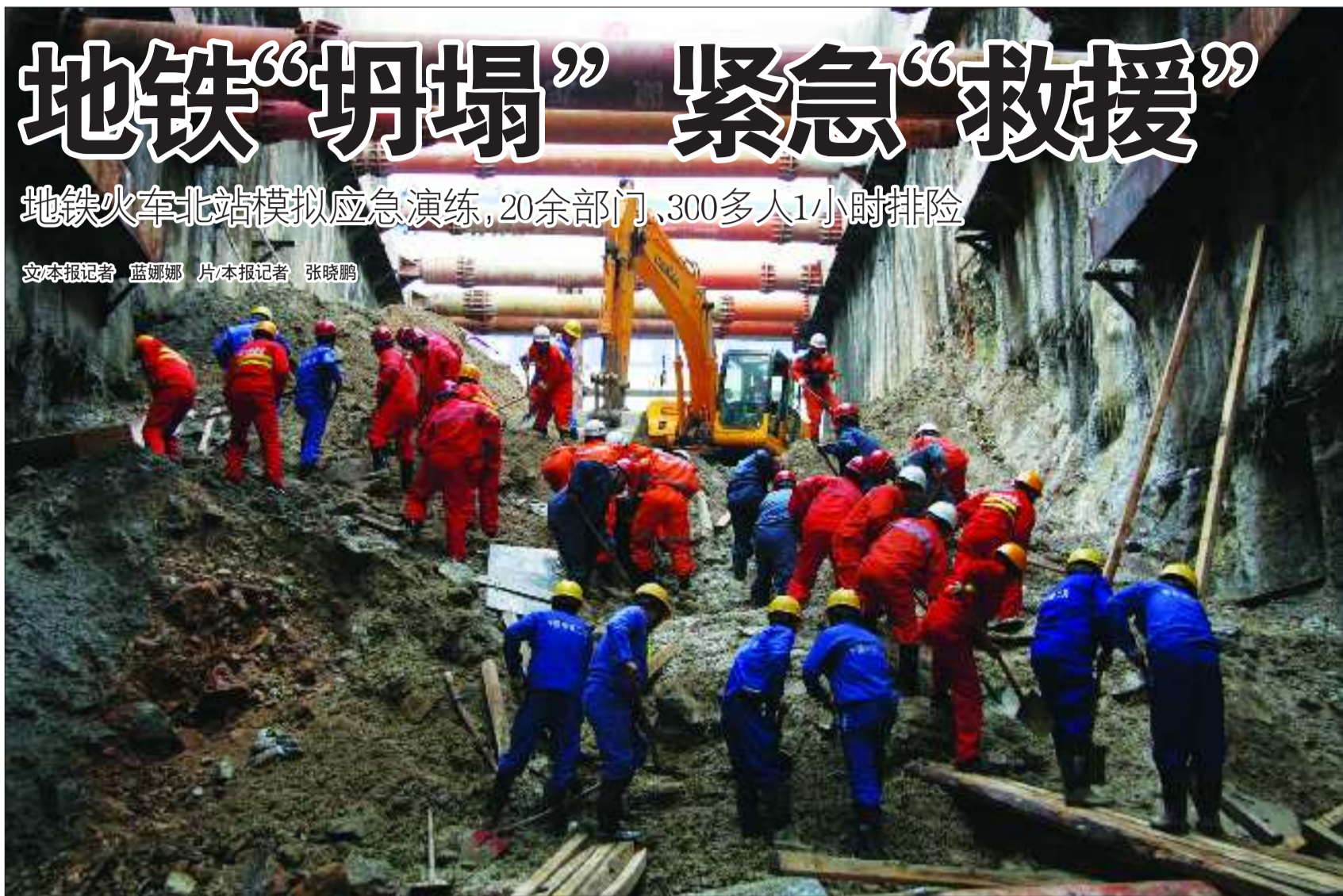
▲图为地铁基坑坍塌“事故现场”,消防、施工单位正在“搜救”。
