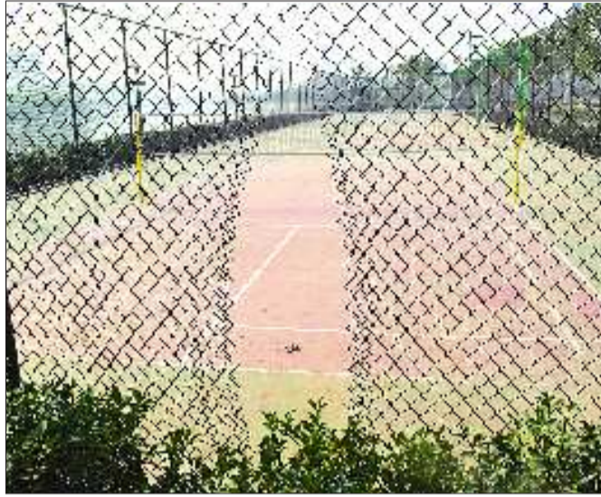
建成好几个月的运动场还未投入使用,就已经被撕开了一个大口子。 本报记者 赵伟 摄
