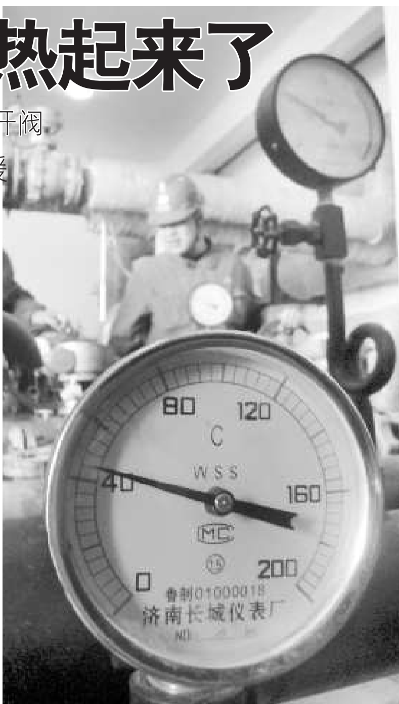
蓝天热力滨河国际换热站开栓供暖后,温度表显示回水温度已达41度。 本报记者 邵琳 展萍 摄
