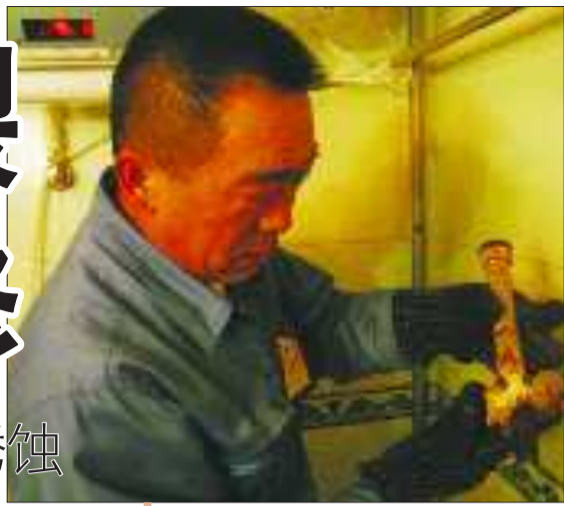
因瓷砖底部泥土潮湿导致管道锈蚀,是居民家供暖发生爆管的主要原因。蓝娜娜 摄
