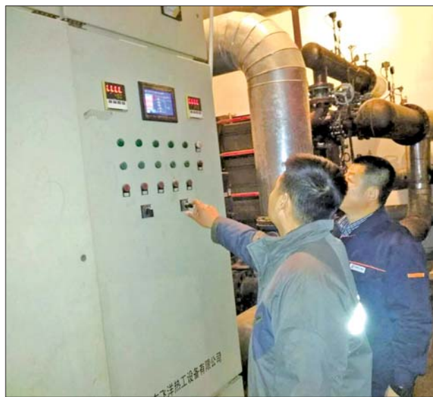
外网值班人员巡检已注水换热站。
