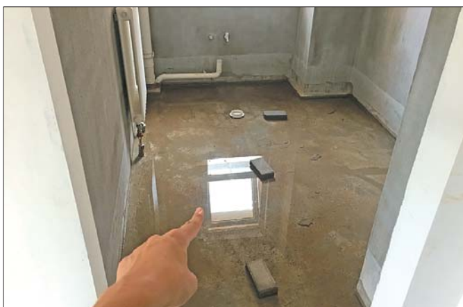
一些套间厨房和卫生间地上满是积水,有的已渗入墙体。
