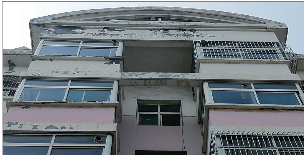
部分墙皮已脱落,露出里面的水泥。 本报记者 刘慧 摄
