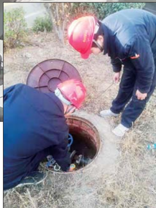
外围巡线人员正在对管区的地热线路进行检查维护。
