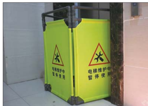
发生坠落的电梯正在维修中。齐鲁晚报·齐鲁壹点见习记者 房体朔 摄
