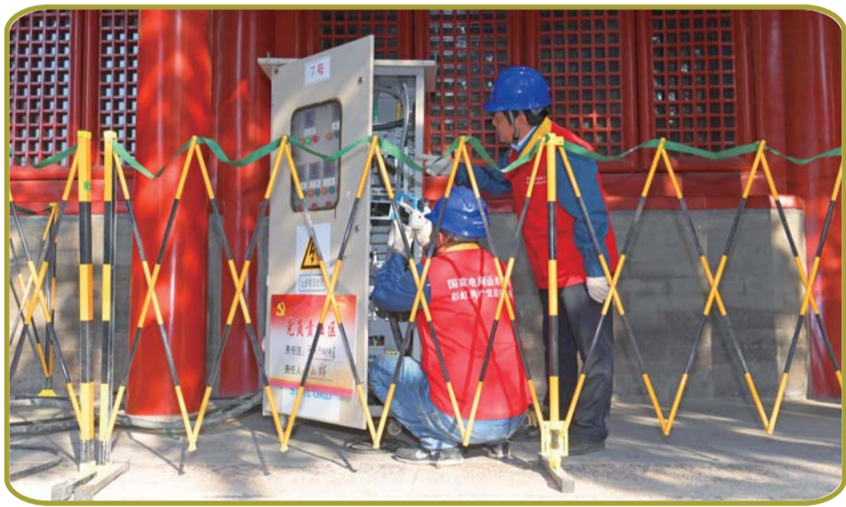
每一处用电设备,工作人员都一丝不苟地检查。
