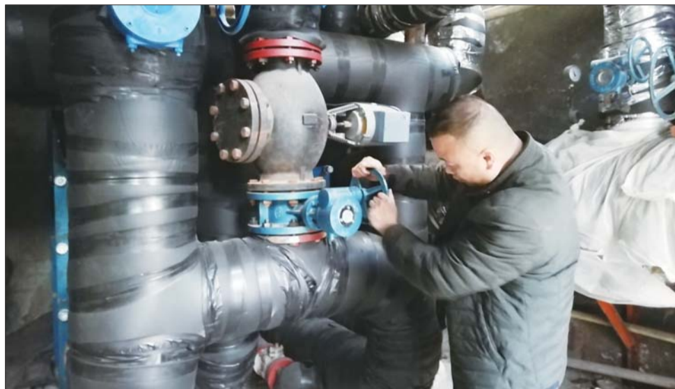
检测换热站运行情况。
