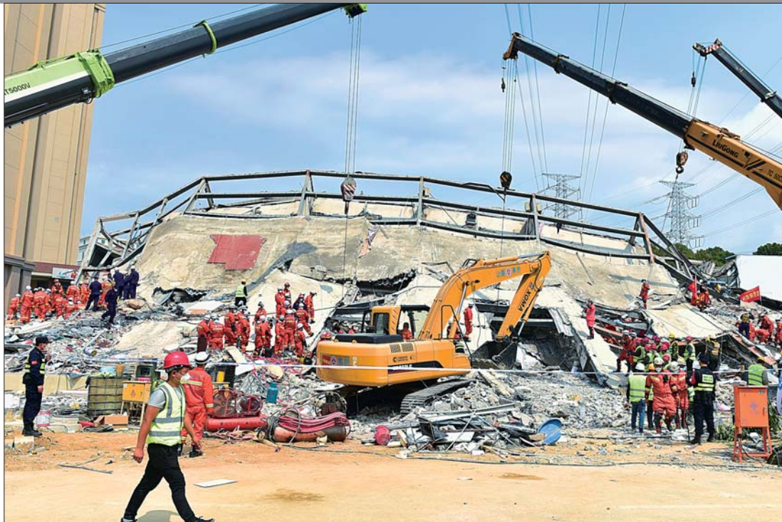
泉州市鲤城区欣佳酒店坍塌事故救援现场。新华社发
