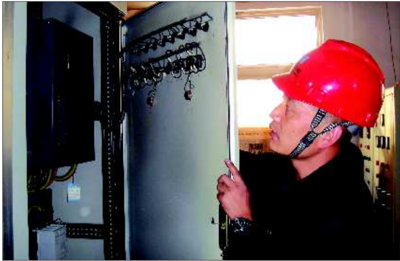
蓝天热力有限公司的工作人员正在调试供暖设备
