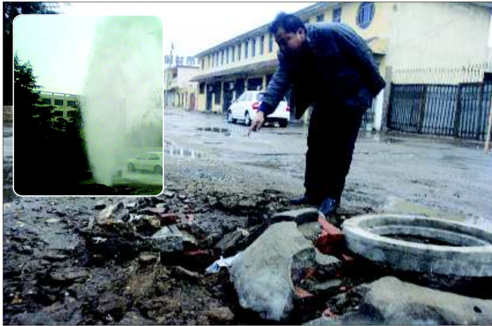
▲附近一店铺店主崔先生指着水管爆裂后水流将地面冲出的缺口。小图为崔先生的儿子用手机拍下了水管爆裂时的景象。
