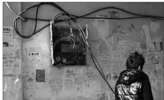
变电箱“张开了嘴”,顺出的电线乱七八糟。 本报见习记者 聂金刚 摄
