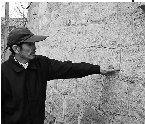
爆破后,邹本广的家里受损最严重,整个外墙布满了裂痕。 本报记者 侯书楠 摄
