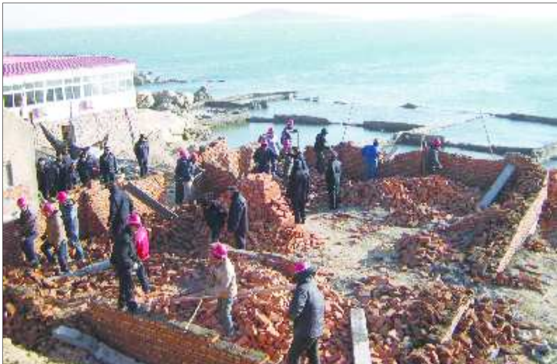
一处以鲍鱼池看守房之名在建的违章房被拆除。 于国松 摄
