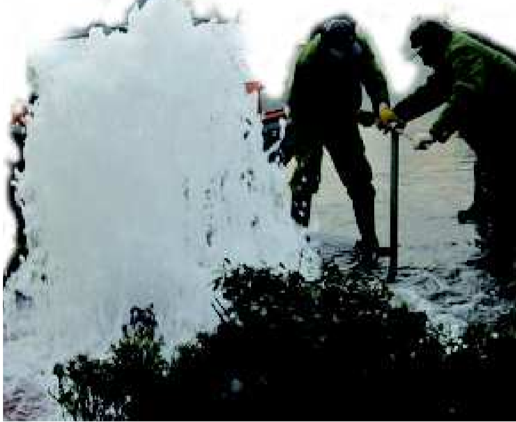
消防栓爆裂后,喷出了近两米高的水柱。
