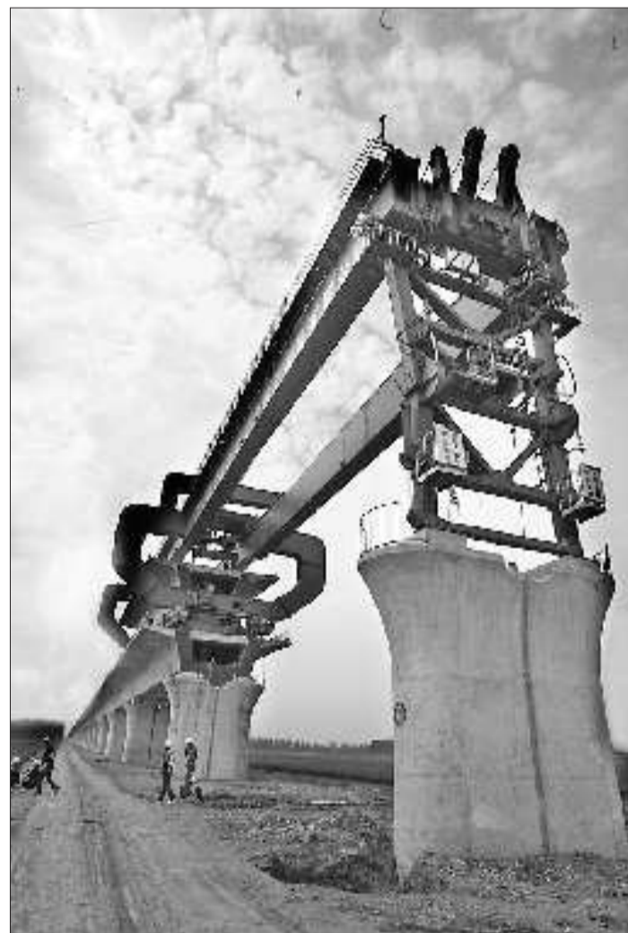
在京沪高铁曲阜段,施工人员正在铺梁(资料片)。本报记者 张晓科 摄
