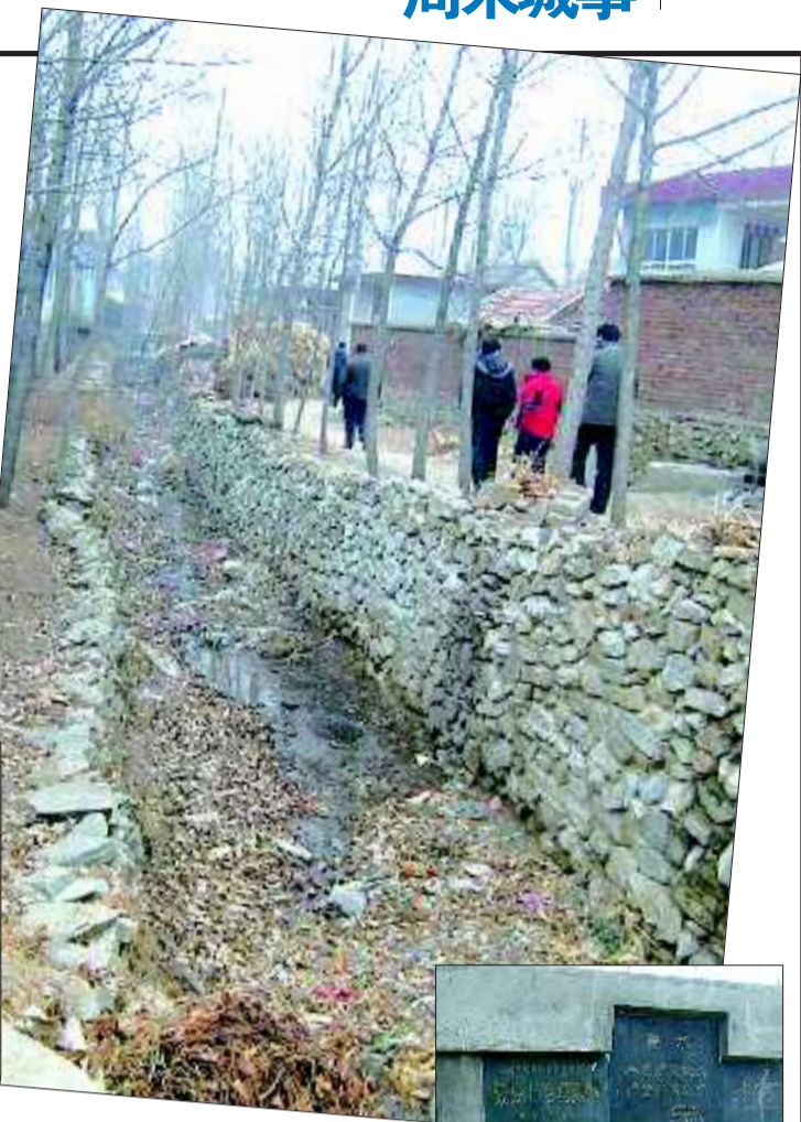
▲许家庄观测井南侧(约6米)水沟沟底水溢出现象。
