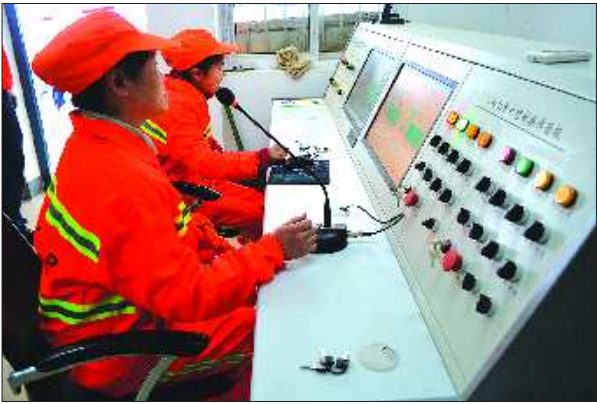
工作人员正在通过中央控制系统对环保型垃圾压缩转运站进行控制。 赵伟 摄
