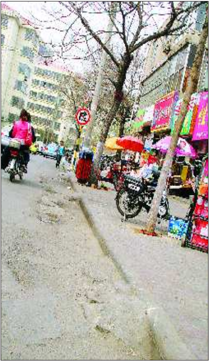
八腊庙街与羲之路交会处附近的路面“接坡”严重,破损的“接坡”更是影响市容。
