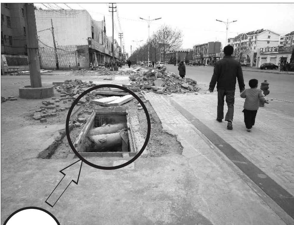
10日下午2时许,在西城北一路与燕山路交会处以西路南,一处被挖掘的路面旁没有任何警示标志,存在严重的安全隐患。市民陈先生说:“这个地方挖开好几天了,晚上也没有警示的标志,从这儿走得提心吊胆的。”
