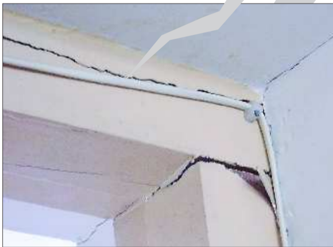
▲4号楼一住户家的墙壁上出现明显裂缝。
