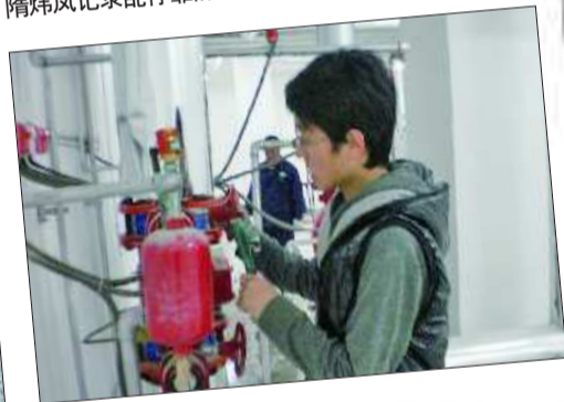
王泓涛在水泵房打开水管阀门。
