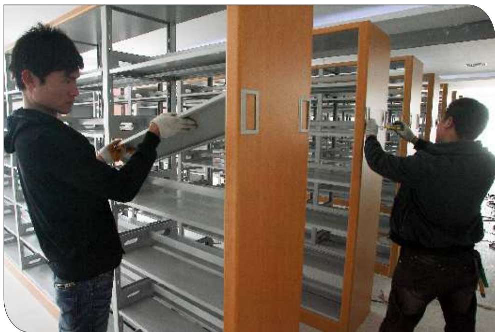
在图书馆施工现场,工作人员正在紧张地安装书架。 记者 廖杰 摄
